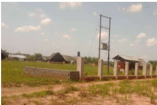
Figuur 6 Ontbrekende hekwerk
